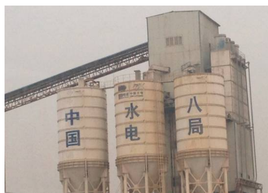
封闭式混凝土拌合楼
