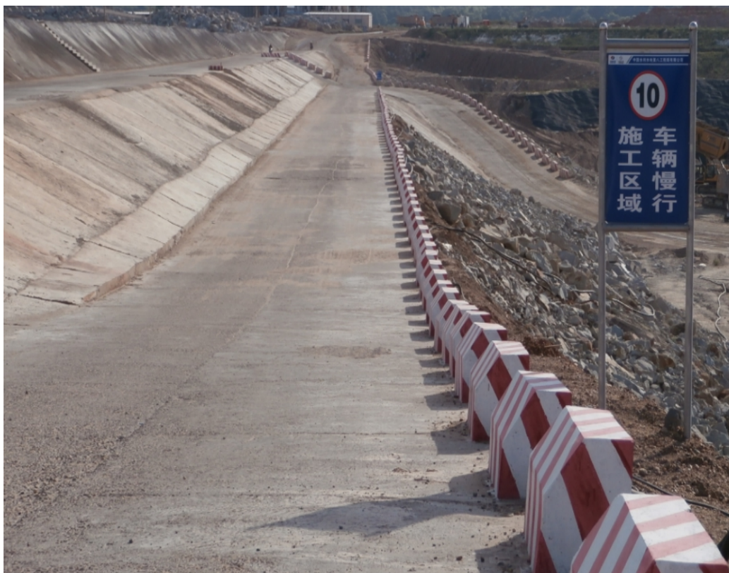
图 4.6-1 施工道路限速标志
